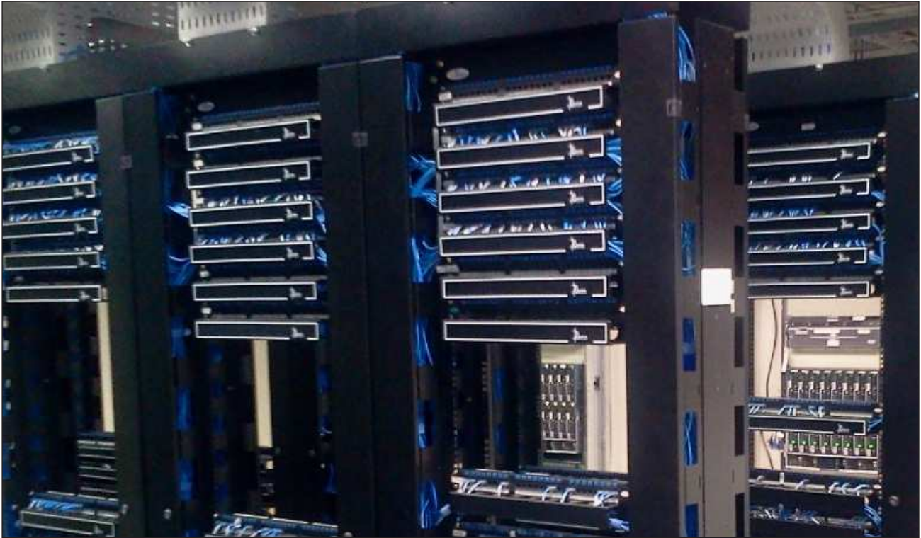
Gambar 1. Rak server di pusat data
